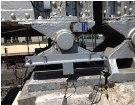
図1：相対変位センサを設置した支承
