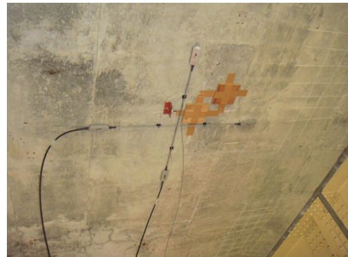
写真-6 実橋光ファイバセンサ設置状況
