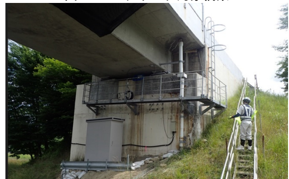
写真-1 モニタリングシステム設置状況
