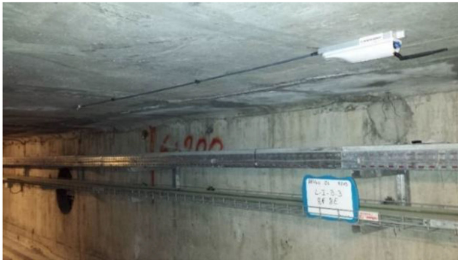
図 1 無線式光学ストランドセンサの設置状況 トンネル内コンクリートスラブ
