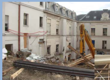
(建物外観と OSMOSセンサー設置状況)
