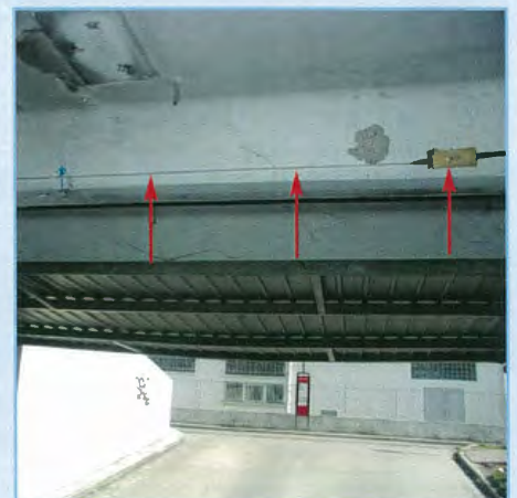
コンクリート梁に設置された 光学ストランド
