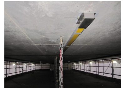
(床版に設置したセンサーカバー付き)
